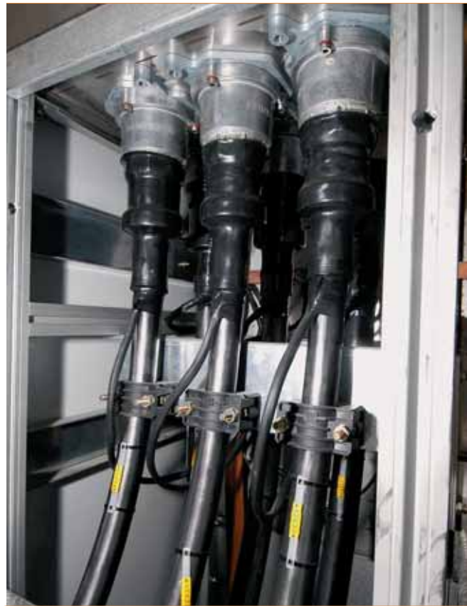
1 Cable subterráneo XLPE de 400 kV de ABB
