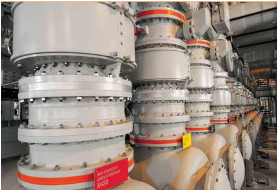
3 La subestación compacta aislada con gas de ABB tiene la superficie adecuada en planta
