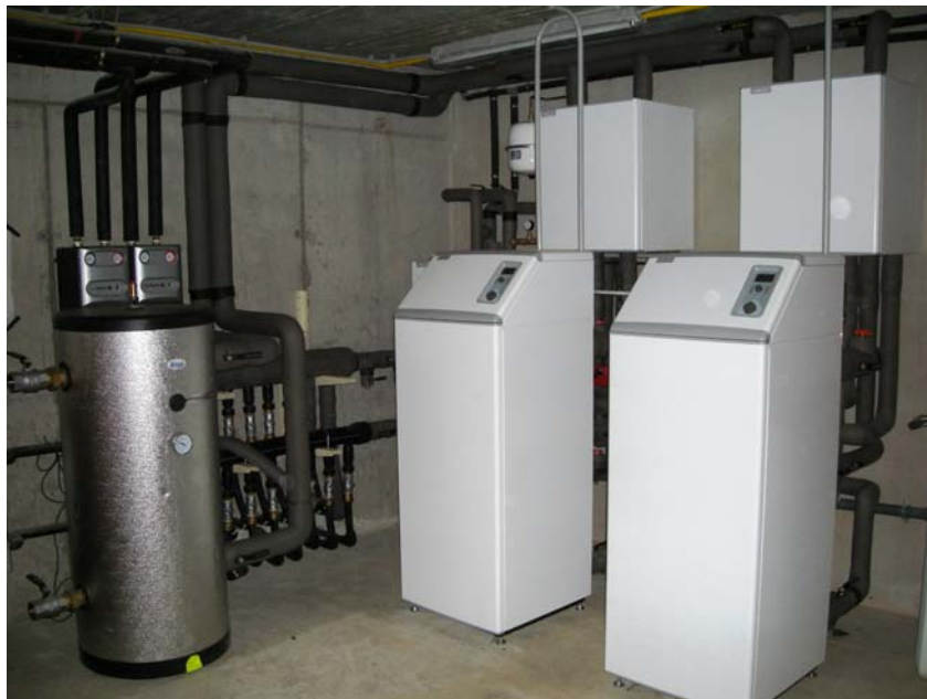
Sala de màquines del Centre Cívic
